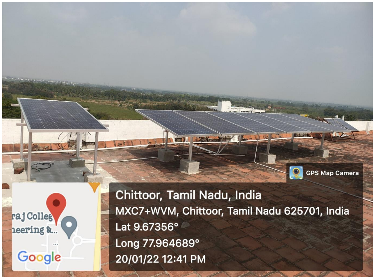
Fig: 7.1.2.1.c Solar PV Arrays ( 2 KW) in D Block
