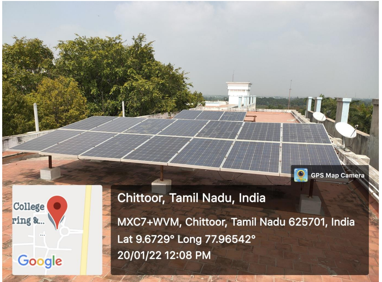
Fig: 7.1.2.1.b Solar PV Arrays ( 5 KW) in A Block
