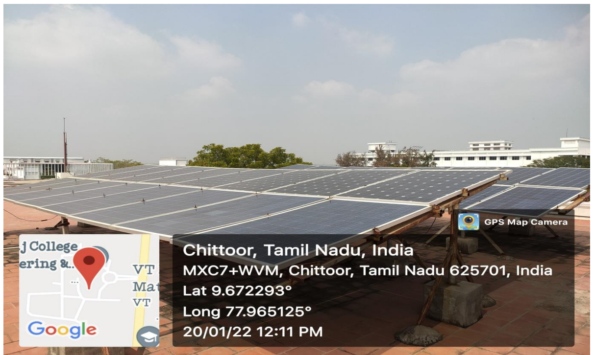
Fig: 7.1.2.1.a Solar PV Arrays ( 25 KW) in B Block
